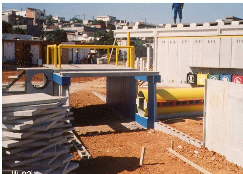
Figura 7: Elementos visuais indicando o tipo de descarte nas lixeiras externas – EMEI Severino do Ramo
